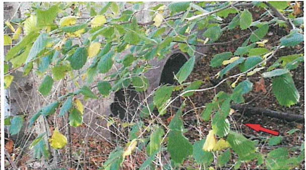
Foto 27: leichte Schwemmgutablagerungen vor der Brücke Erfurter Str.
