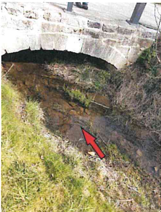
Foto 20: (aus 2021) Ablagerungen unter der Brücke
