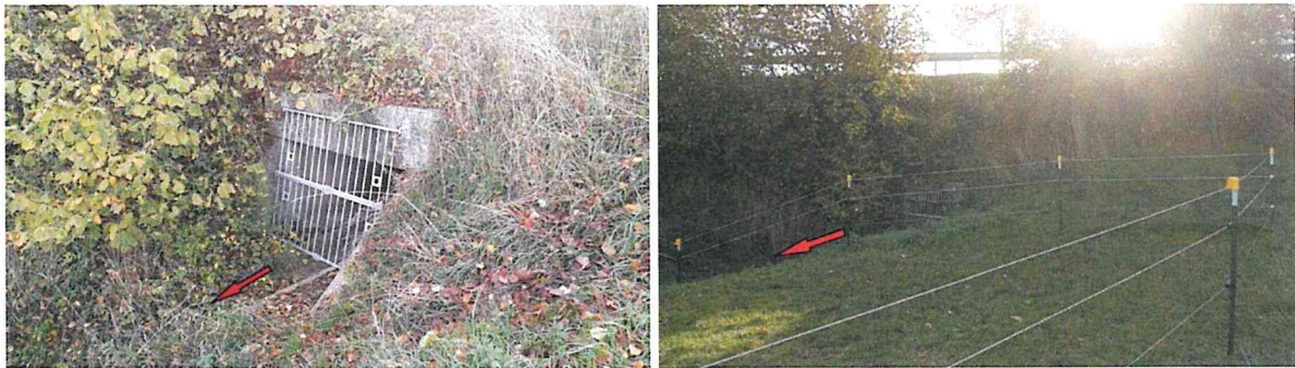
Foto 5 und 6: Rechen am Ende des B7- Durchlasses
