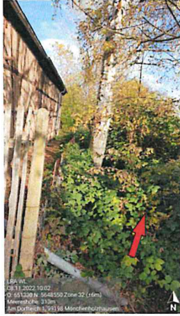
Foto 23: abflussbehindernder Bewuchs Brombeerhecke
