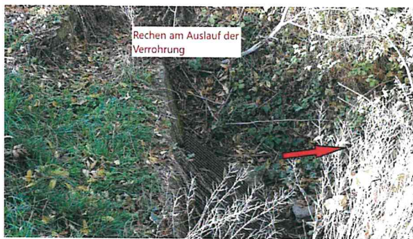
Foto 14: Auslaufrechen Verrohrung Vieselbach
