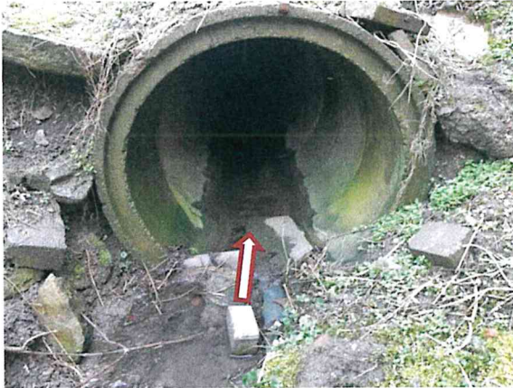
Abbildung 11: Einlauf Verrohrung DN1000 ohne Gitter
