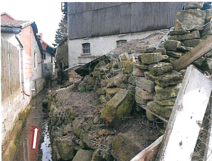
Abbildung 10: Ablagerung von Steinblöcken im Böschungsbereich
