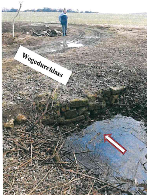
Abbildung 1: nicht intakter Wegedurchlass
