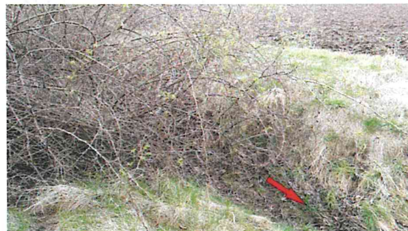
Foto27 bis 31 teilweise zugewachsenes Abflussprofil
