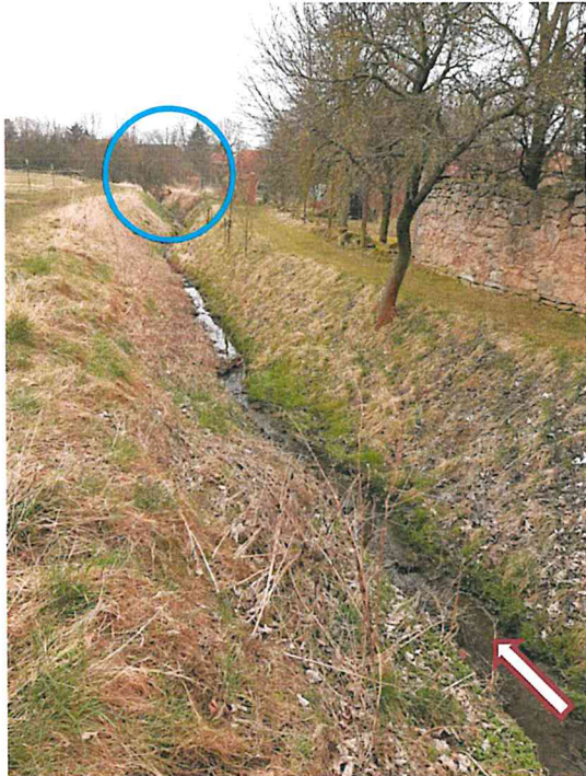
Abbildung 26: Blick in Richtung Uferabbruch
