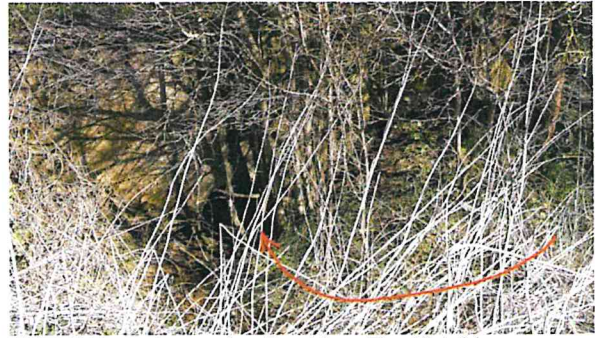
Foto 46 Bewuchs vor dem Durchlass Flurstück 61
