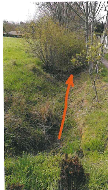
Foto 23 Grabenprofil in Höhe Zufahrt Gartenanlage
