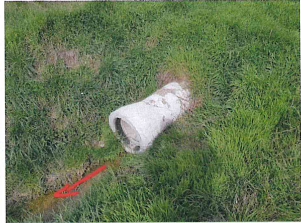
Foto 16: Auslauf aus der Verrohrung
