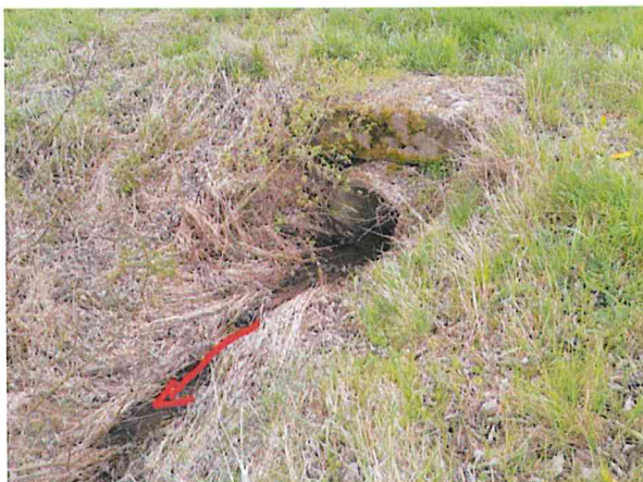
Foto 4: Einlaufbereich des Grabens Fahner Weg in den Hauptgraben
