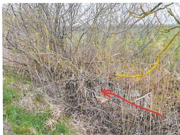
Foto 13 und 14: abflussbehindernde Sträucher im Abflussprofil
