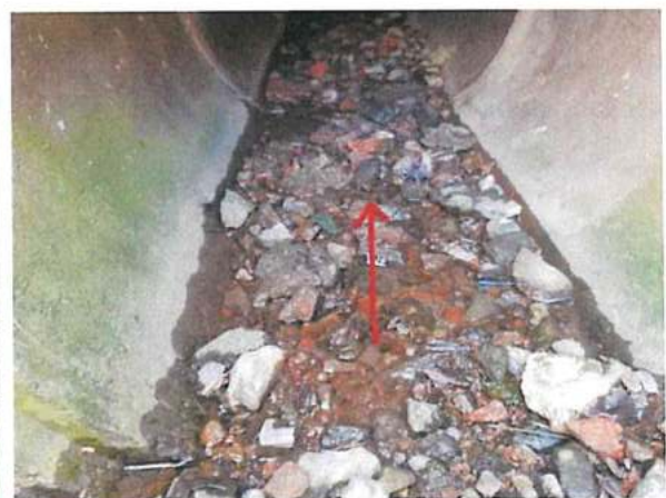
Foto 7: Ablagerung von Bauschutt und Sedimenten in der Verrohrung
