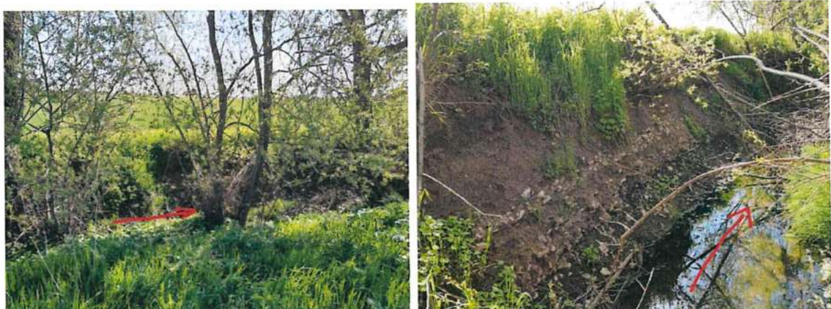
Foto 30 und 31: Uferabbruch links
