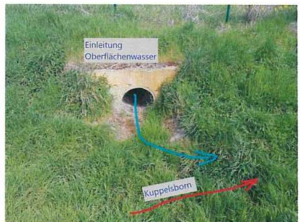
Foto 65: Einleitungsbauwerk für Oberflächenwasser im Bereich der agrar Bienstädt GmbH
