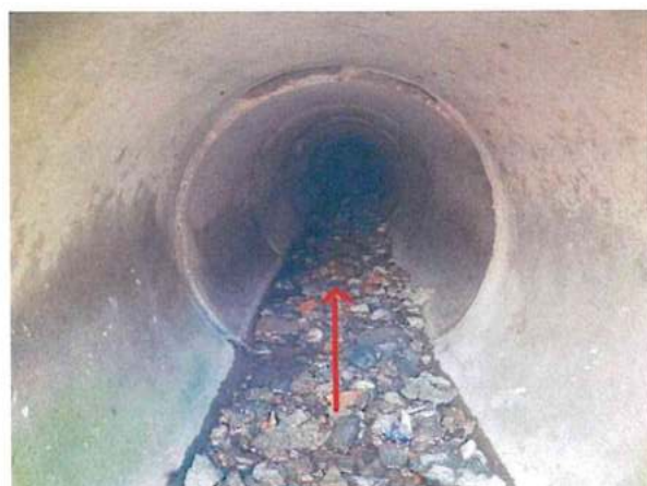
Foto 8: offene Fugen und Lageverschiebung der Rohre
