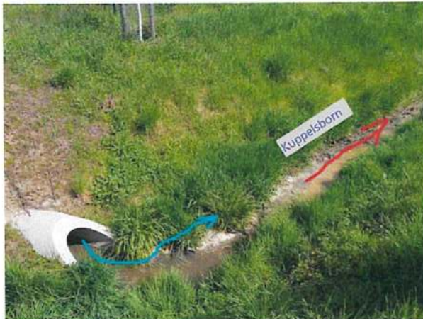
Foto 66: Einleitungsbauwerk agrar Bienstädt GmbH
