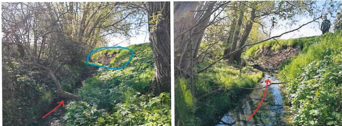
Foto 28 und 29: Uferabbruch rechts
