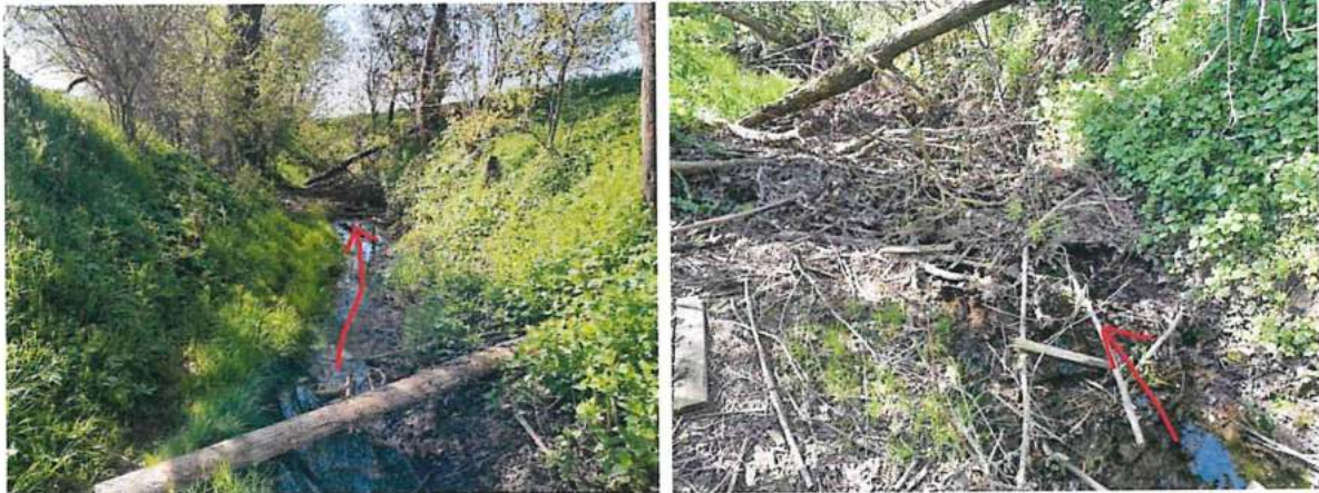
Foto 26 und 27: Schwemmgut aus Totholz
